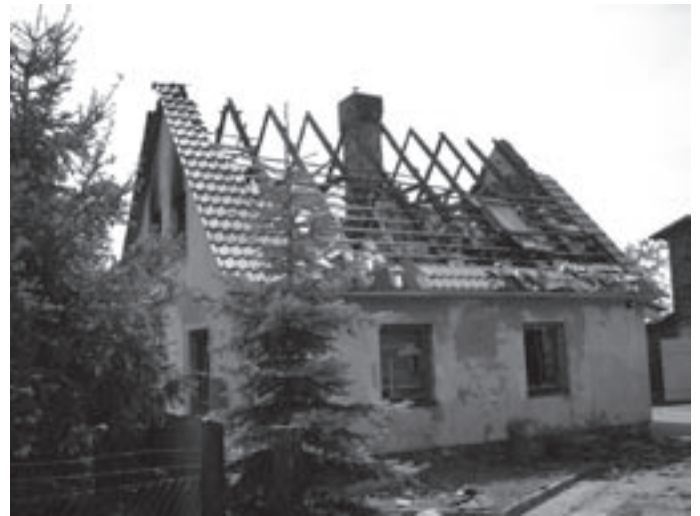
Einsatz 26, Wohnhausbrand in Gellin
