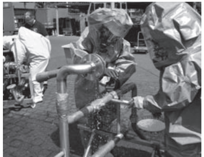
Werkfeuerwehr Bayer-Schering-Pharma Werke, Kamerad Tobias Schmidt und Felix Krüger beim Abdichten von Rohrleckagen
