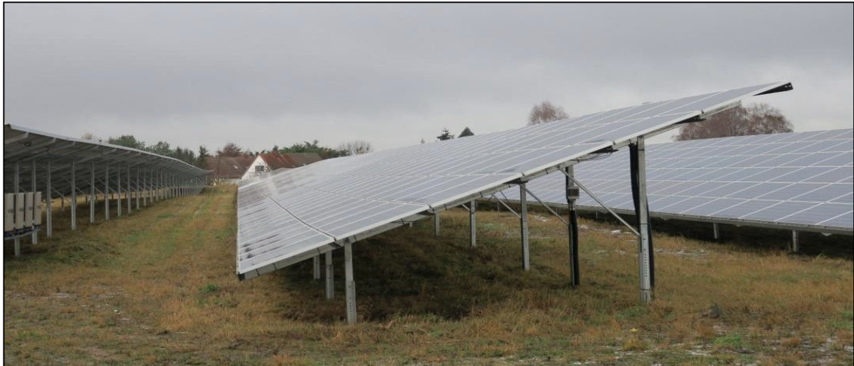
Abb. 1: Beispiel einer vergleichbaren PVA in Mecklenburg-Vorpommern
